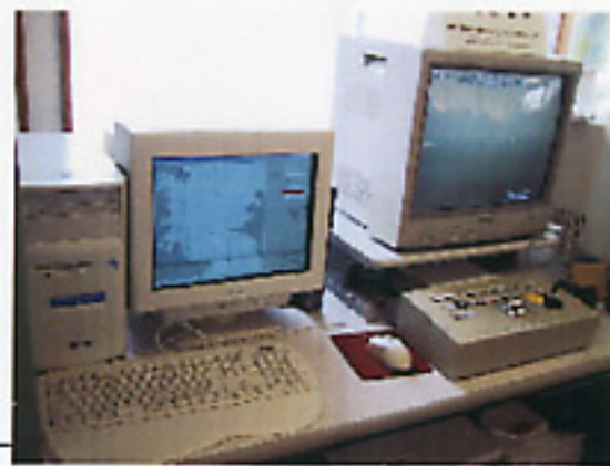
監視装置(操作部、モニタ、地図システム)
