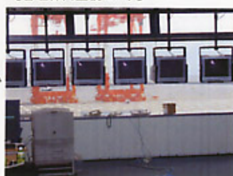
【管理棟内監視モニタ】
