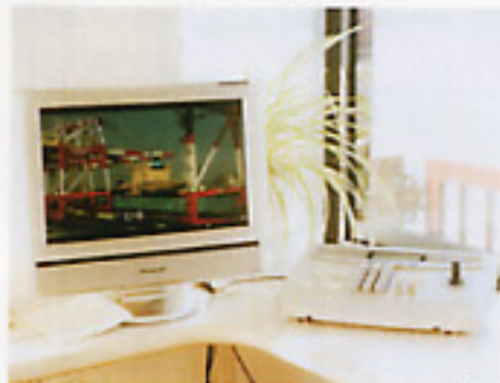
【守衛所内監視モニタ】
